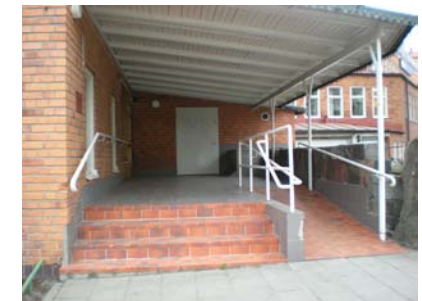
Tillbyggnad av ramp med beläggning som inte riktigt passar till teglet.
