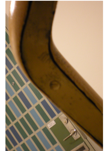
Räckets originalfärg syns fortfarande på överliggarens undersida.
